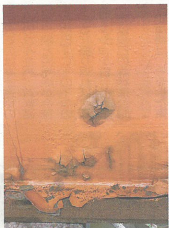
塩の影響で塗膜下腐食
